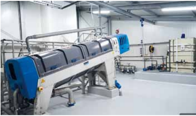
Schneckenpresse Q 620.2 mit Polymeraufbereitungsanlage
